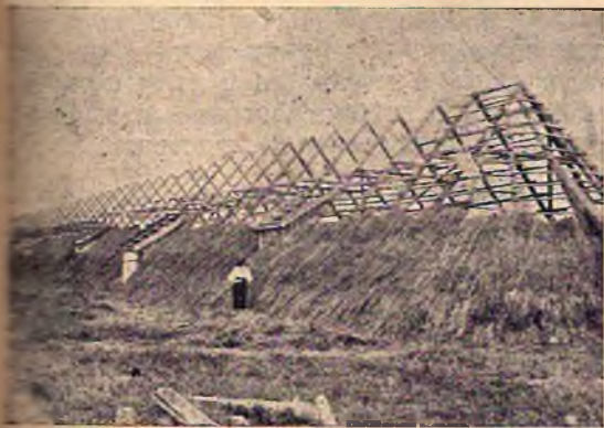
Ремонт сарая, разрушенного шурганом (12 пар стропил были сломаны нанесенным на крышу снегом)
